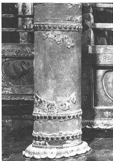
2 翼柱下部 (翼柱、修理前)
