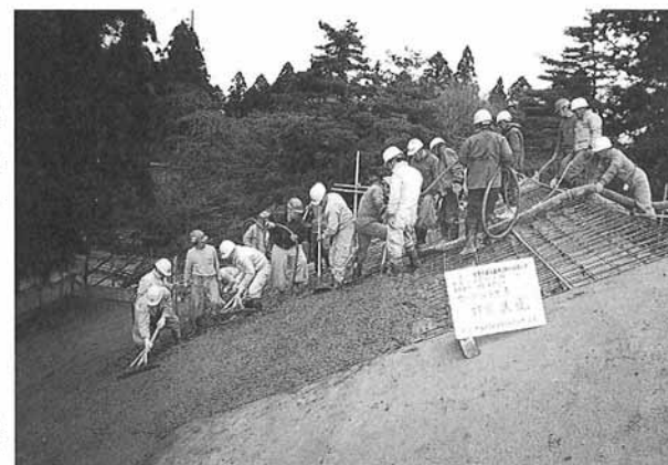
平成十年十二月 コンクリート工事 屋根スラブコンクリート打設
