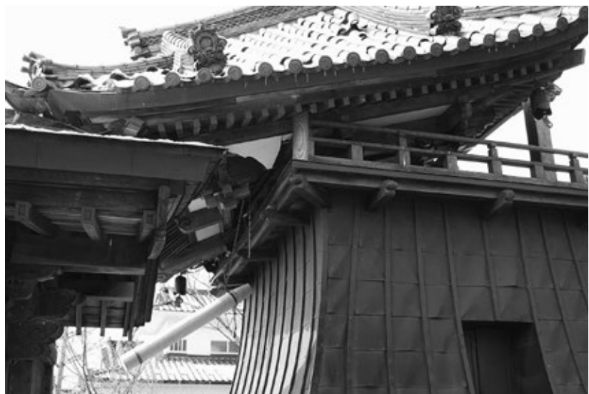
二階建ての鐘楼堂は屋根が崩れた
